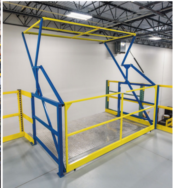
También se han habilitado puertas batientes de seguridad para crear una zona de carga y descarga de mercancía manipulada mediante carretillas elevadoras.
