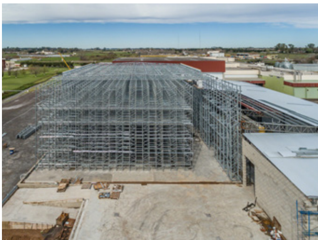
Depósito autoportante con cámara para producto congelado.
